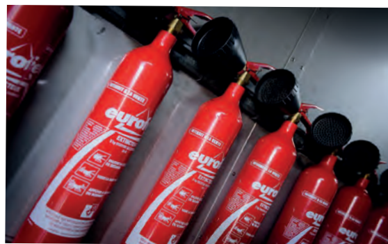
Extincteurs©Arnaud Bouissou - TERRA
